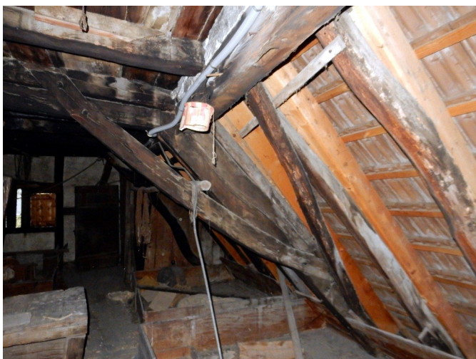
Habsheim : maison 10 rue du maréchal Foch, état en 2015, charpente de 1476-77, détail ferme « couchée » (photo de l'auteur)
