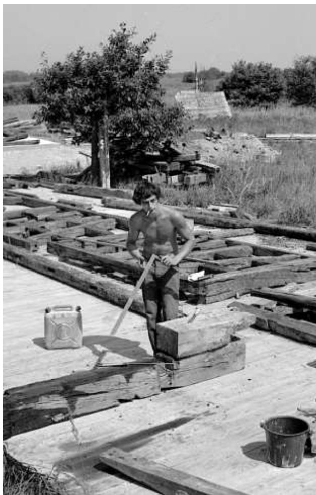
Sur le chantier de l'écomusée en 1981 : la préparation au sol de la charpente du pigeonnier d'Oberhergheim.
